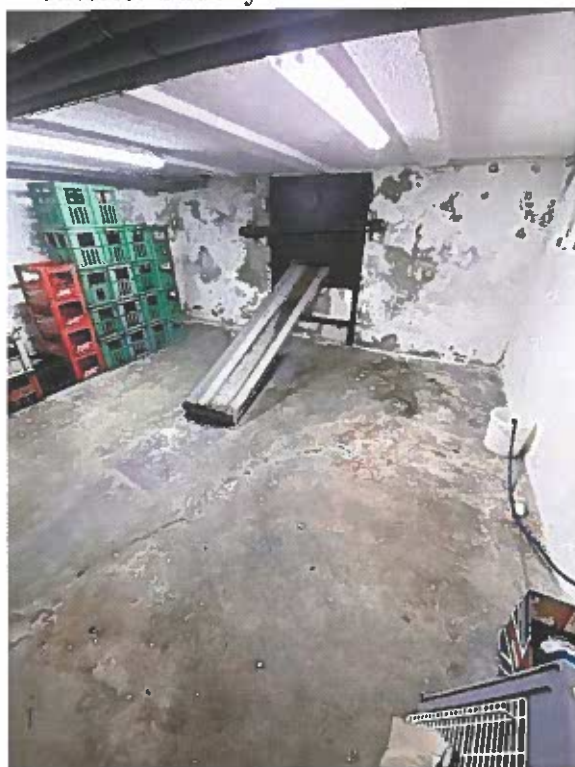
Sklad vybavený shozem
