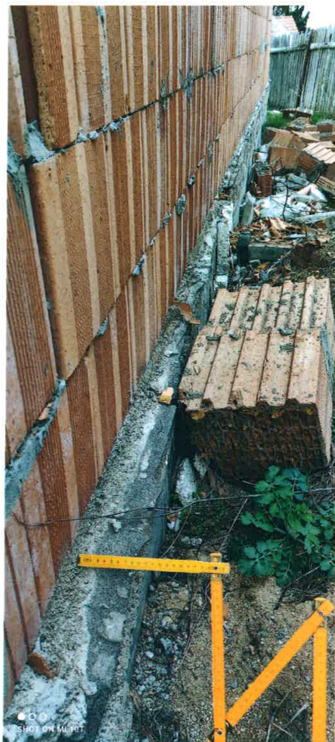
Obr. 12 – nepřesnosti vytýčení základů ve vztahu k obvodovým stěnám
