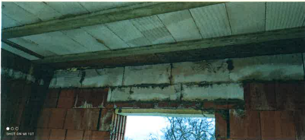
Obr. 5 – chybně osazené prefabrikované překlady, stropní nosníky ze systému Ytong klasik a místo stropních vložek výšky 200 mm jsou osazeny příčkovky Ytong tl. 100 mm
