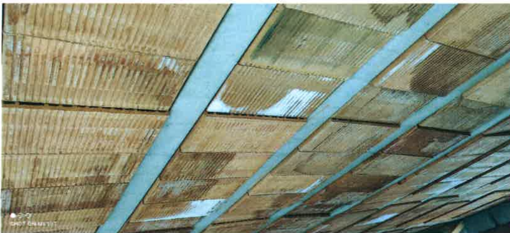
Obr. 6 – chybně provedená stropní konstrukce z nosníků ze systému Ytong klasik a keramických vložek Miako 15/62,5
