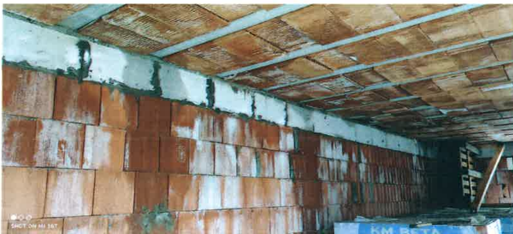
Obr. 7 – chybně provedená stropní konstrukce z nosníků ze systému Ytong klasik a keramických vložek Miako 15/62,5
