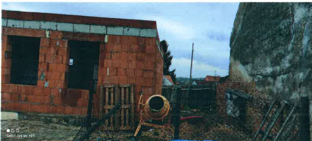
Obr. 4 – zakřivené pravá štítová stěna
