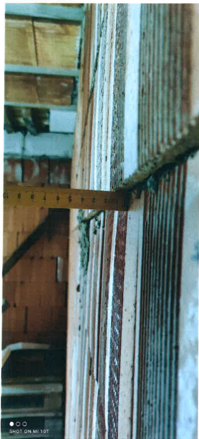
Obr. 8 – nerovnosti při zdění obvodové stěny, vrstvy cihel jsou vzájemně posunuty 10 až 20 mm
