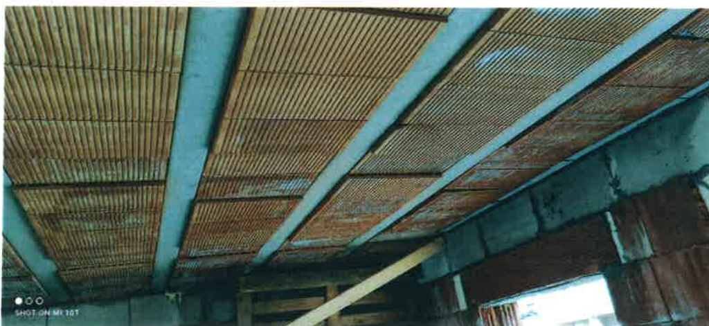
Obr. 9 – chybně provedená stropní konstrukce z nosníků ze systému Ytong klasik a keramických vložek Miako 15/62,5, keramické vložky rozměrově nesedí k nosníkům systému Ytong klasik
